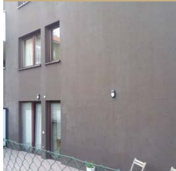
05| Svetlé plochy na povrchu fasády.
