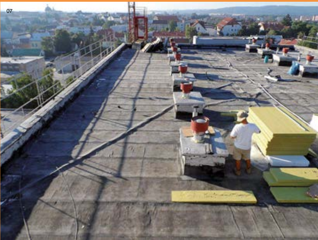
07| Nerovný podklad s natavenou parozábranou a provizórnou hydroizoláciou z SBS modifikovaného asfaltovaného pásu.
