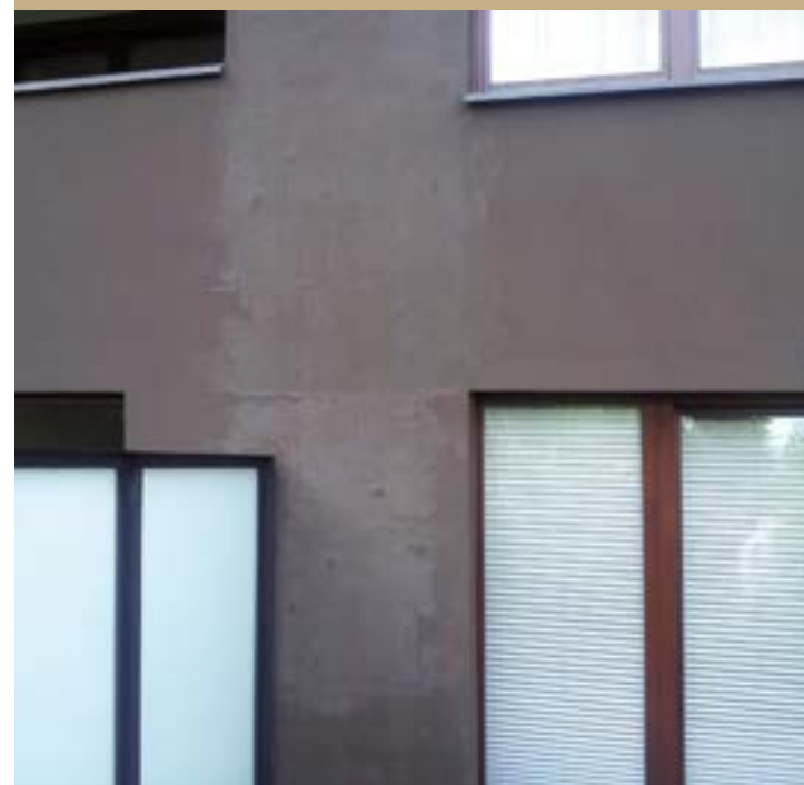
06| Svetlé plochy na povrchu fasády.
